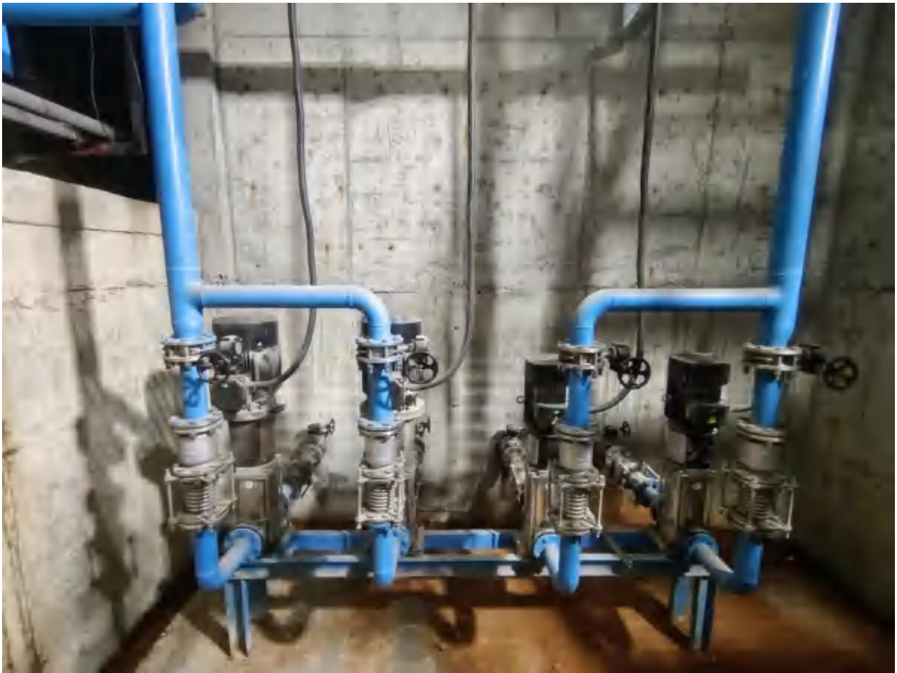
附件 1-8-4 循环水、节水器具照片
