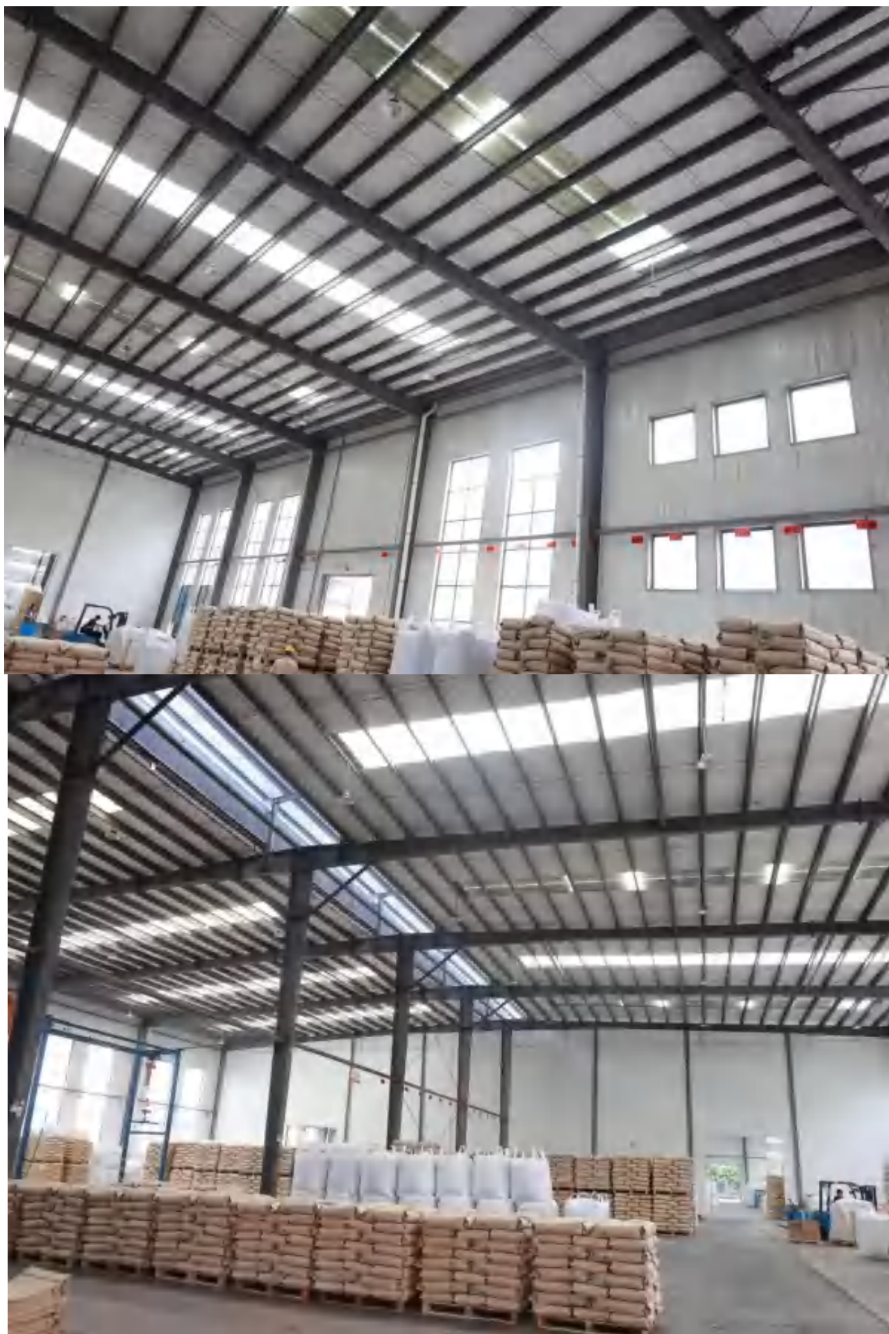
附件 1-10-2 厂区采用自然光照明照片
